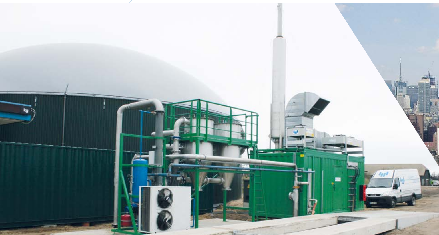
// 400 kW Biogasanlage mit Gasreinigung in Deutschland
