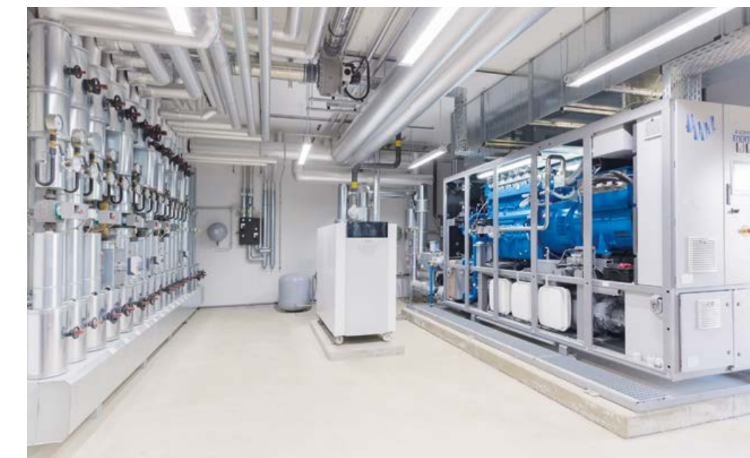
// 140 kW BHKW zur Versorgung einer kommunalen Einrichtung in Deutschland
